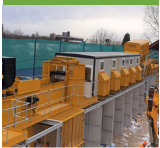
Planta de valorización de RCD
